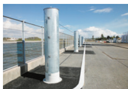
工場の漂流物対策「津波スクリーン」
